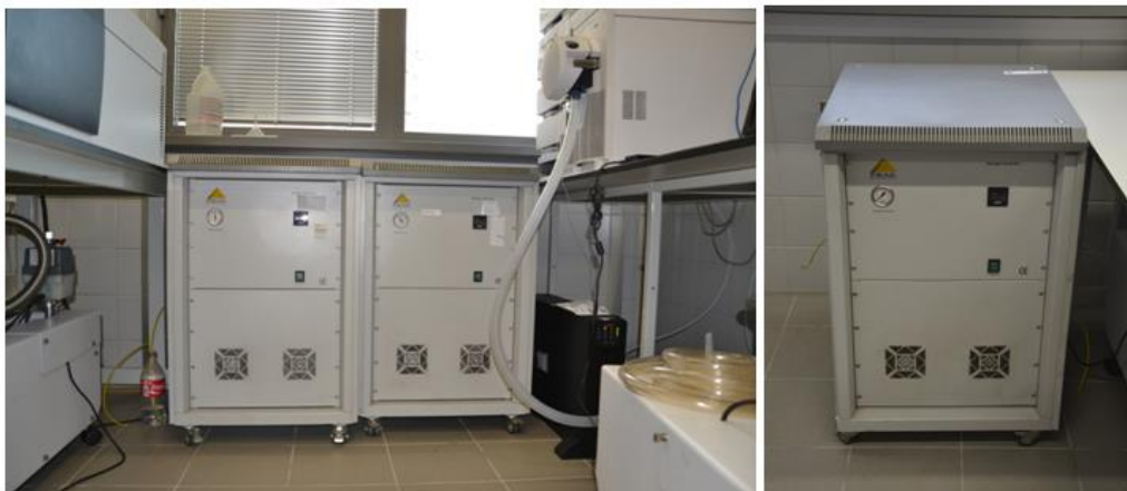
1. Generatory azotu znajdujące się w pomieszczeniu 2.14.
