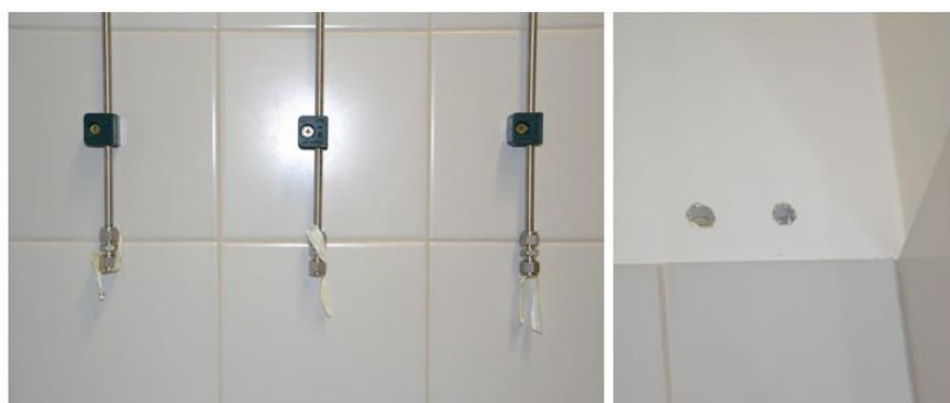
5. Istniejąca instalacja azotu w pomieszczenie 2.14A.
